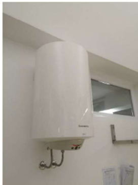
Slika 6: Lokalna priprava sanitarne tople vode
