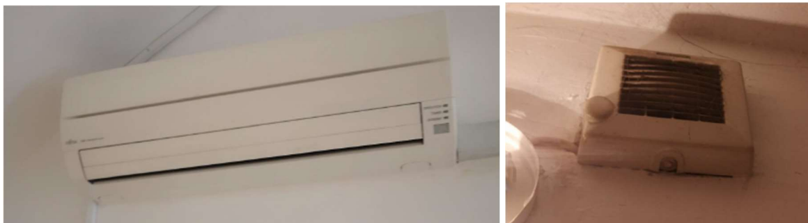
Slika 9: Klimatska enota in odvodni ventilator
