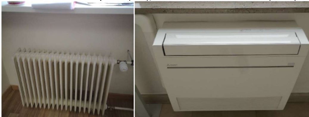
Slika 5: Radiator v pisarni (levo); stenski konvektor na hodniku (desno)
