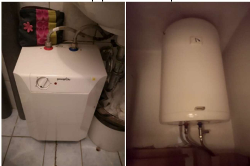
Slika 6: Lokalna priprava sanitarne tople vode
