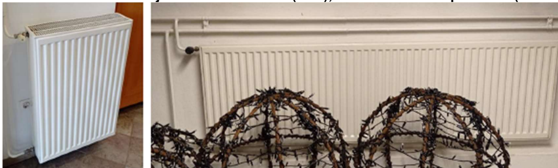
Slika 5: Radiatorji na vhodu v stavbo (levo); radiator v kletnih prostorih (desno)
