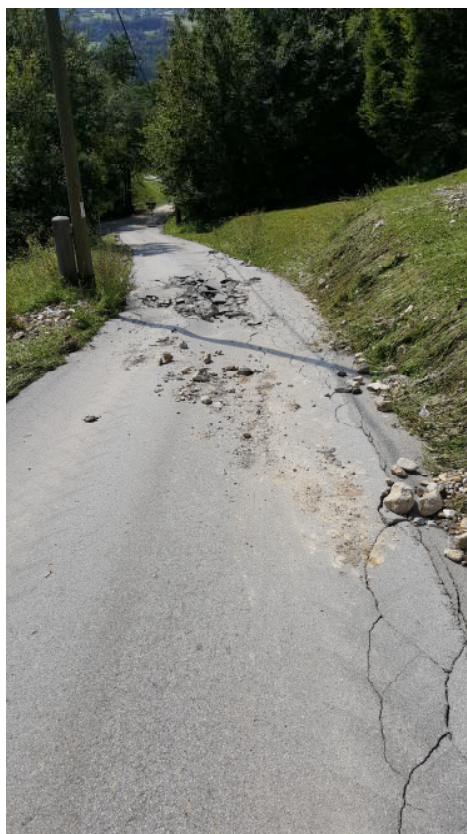
Slika 1: Uničeno cestišče (KS Sedraž)
