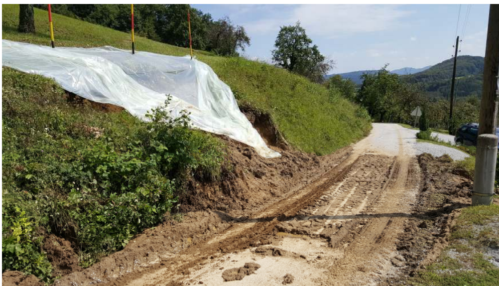
Slika 4: Plaz nad JP v KS Sedraž
